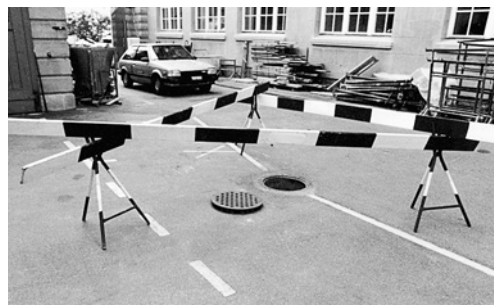
9 Temporär abgeschränkte Reparaturstelle.
